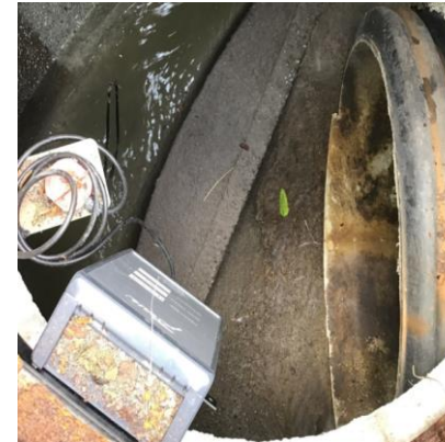
Overløpssensor i kum
